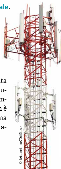
◀ Antenne 5G su una torre di trasmissione.
