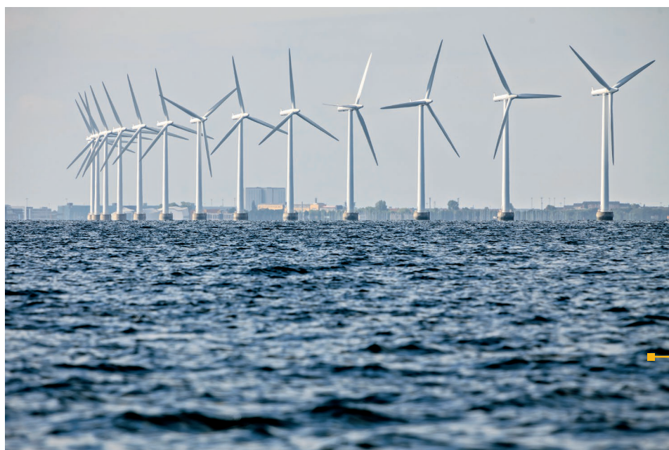
L'impianto eolico più grande della Danimarca, nel mare del Nord vicino al porto di Esbjerg. © ICP
